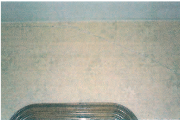
Fissuration intérieure, tapisserie déchirée - Maison André.
